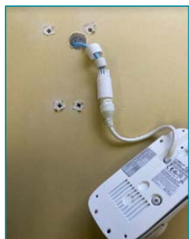
⑥敷設したLANケーブルに防水コネクタを取付し、カメラ側と接続する ※カメラの落下に注意
